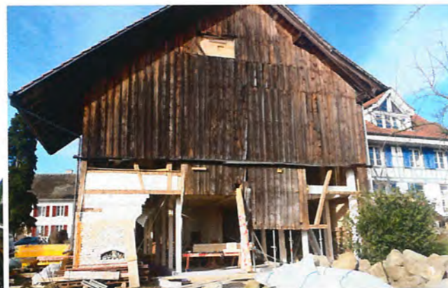
Während im Innern schon die neue Tragstruktur steht, sind noch Teile der alten Fassade zu sehen. Foto: SJB
